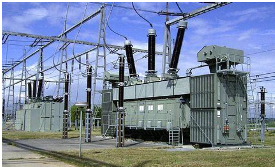
Figure 1.9 Un transformateur de puissance dans un poste électrique [28]
