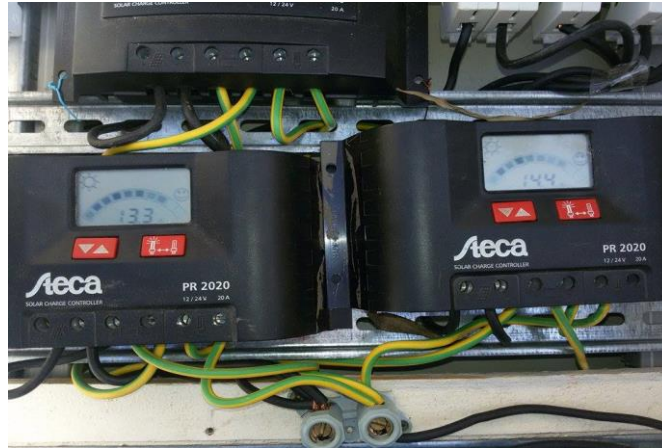
Figure V.4: Régulateurs de charge 12V /20A
