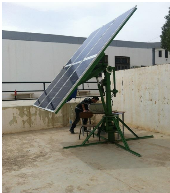
Figure V.2 : Vue du générateur photovoltaïque [111]
