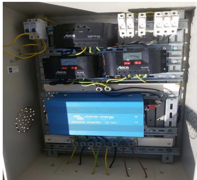
Figure V.3 : Composants de l'armoire électrique
