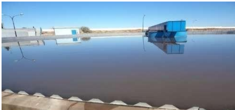
Figure n 11 : Le décanteur secondaire
