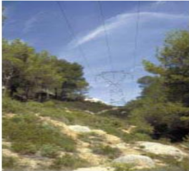
Figure I.15 : Ligne haute tension en forêt (France)
