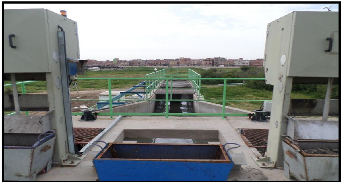
Figure n° 9 : Les deux dégrilleurs automatiques et un dégrilleur manuel (ONA SBA, 2021).
