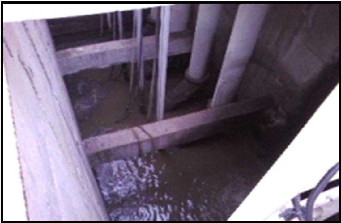
Figure n°8 : le relevage par des pompes submersibles (ONA, SBA, 2021)
