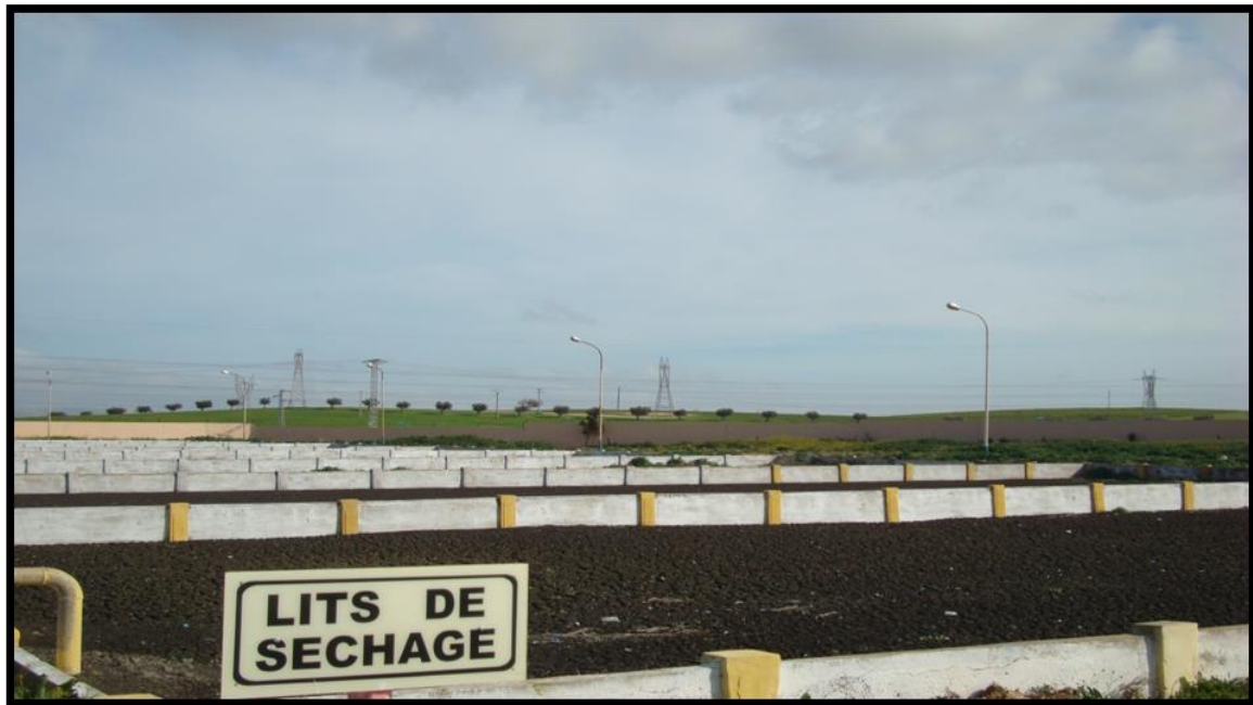
Figure n°19 : Les lits de séchage (ONA, SBA, 2021).
