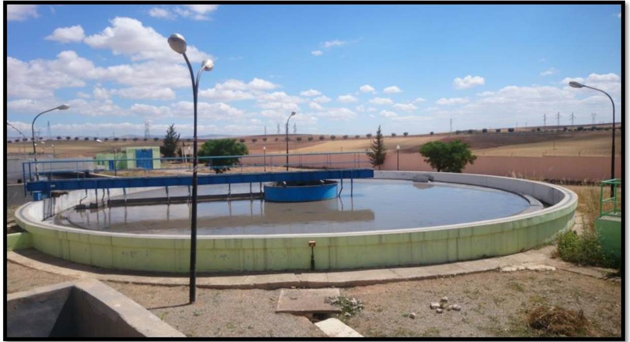
Figure n° 12 : Le décanteur primaire (ONA, 2021)
