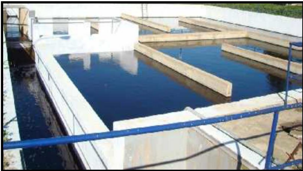
Figure n° 16 : Bassin de chloration (ONA, SBA, 2021).
