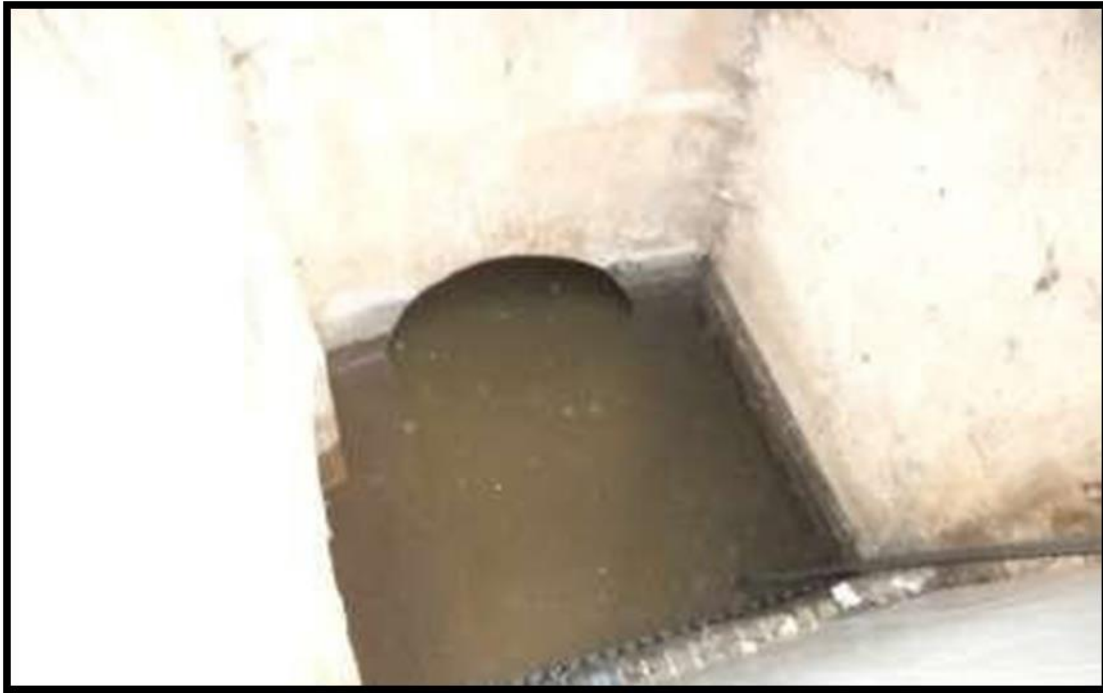
Figure n°7 : Déversoir d'orage submersible (ONA, SBA, 2021)
