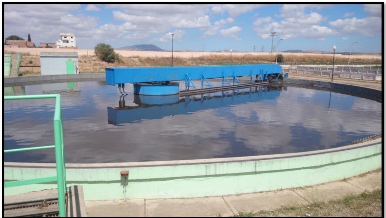
Figure n° 15 : Décanteur secondaire (ONA, SBA, 2021).
