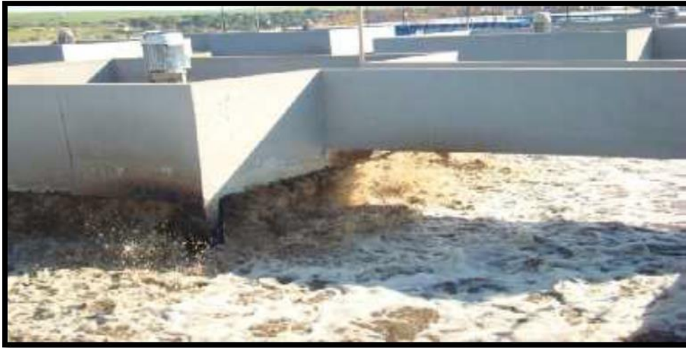
Figure n° 14 : Bassin d'aération (ONA, SBA, 2021)
