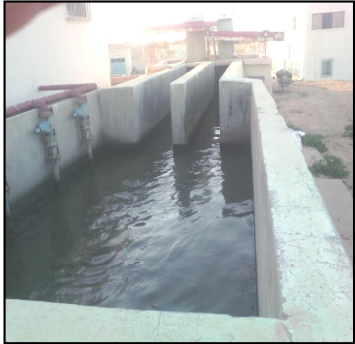
Photo 4. Effluents bruts de la station de relevage de lagune de Naâma (Chadli, 2017).
