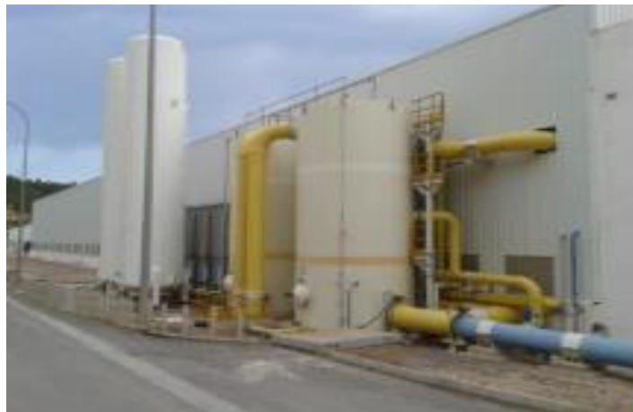
Figure 24 : photo des réservoirs de co 2 (Atallah, 2014)
