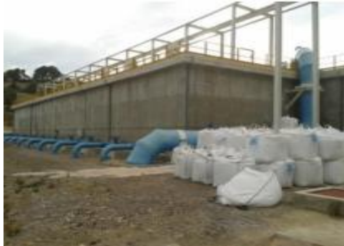
Figure 23 : photo du réservoir de l'eau dessalée
