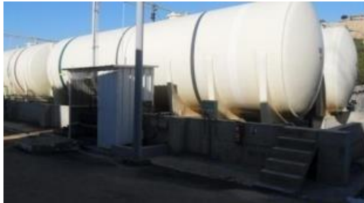
Figure 16 : photo de la citerne de stockage de chlorure ferrique
