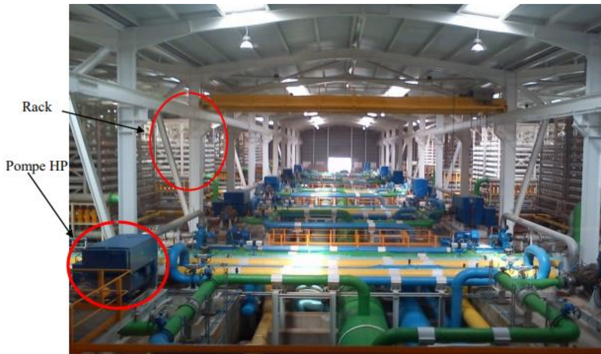
Figure 21 : photo du bloc d'osmose inverse
