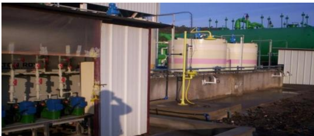
Figure 17 : photo des citernes de stockage du métabisulfite de sodium
