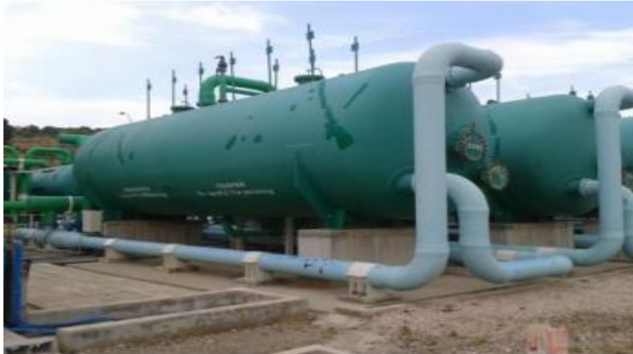
Figure 19 : photo des filtres à sables et anthracite
