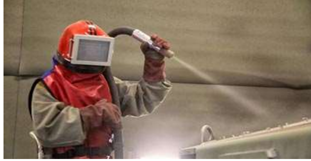
Figure III.3. Exemple d'une préparation de surface par sablage [98]
