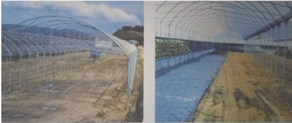
Figure 07 : Installation d'une serre (la structure portante est réalisée en fer galvanisé avec des colonnes verticales) (Web Master ,01)
