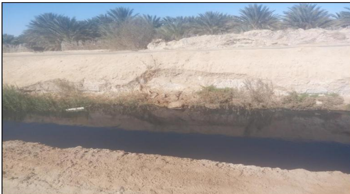
Figure 21 : Destruction des berges du canal en sable à cause des turbulents.
