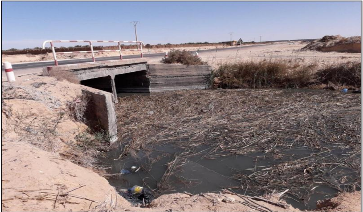
Figure 25 : Rejet d'eaux usées sans traitement directement dans le canal. IN ( BEN SAHA et MESTOURI, 2020)
