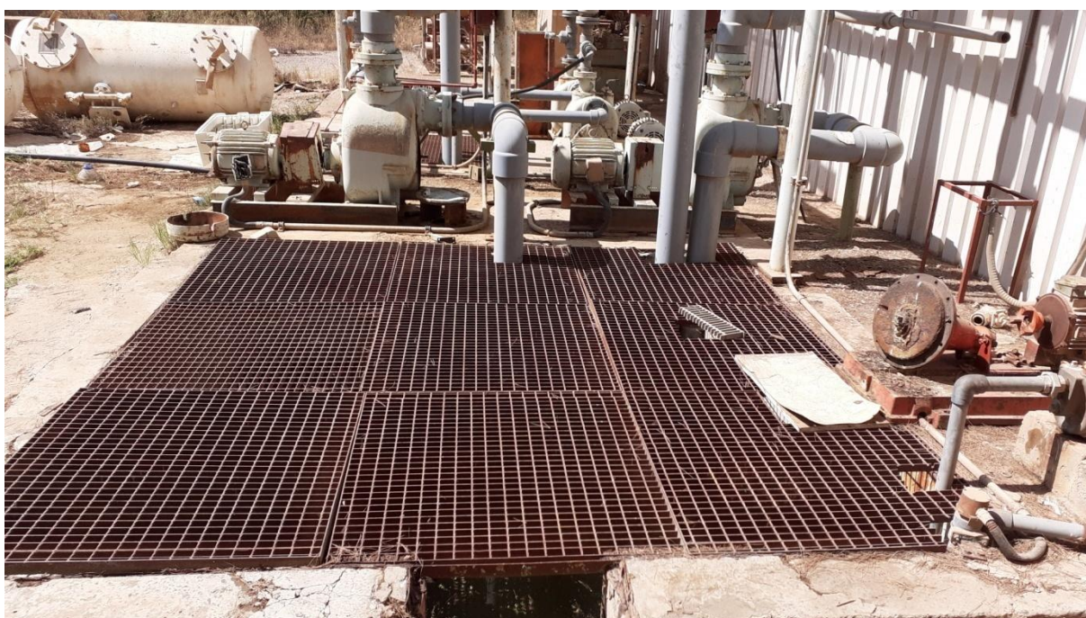
Figure08 : la fosse de rejet final
