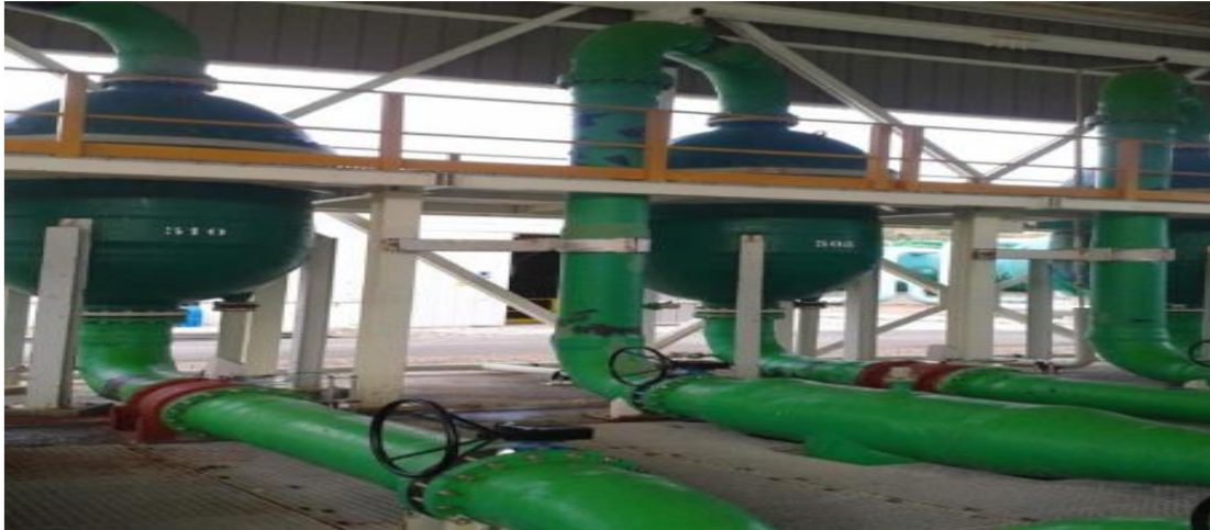
Figure n° (14) : Filtres à cartouches au niveau de la station (Station de Dessalement-Honaine).
