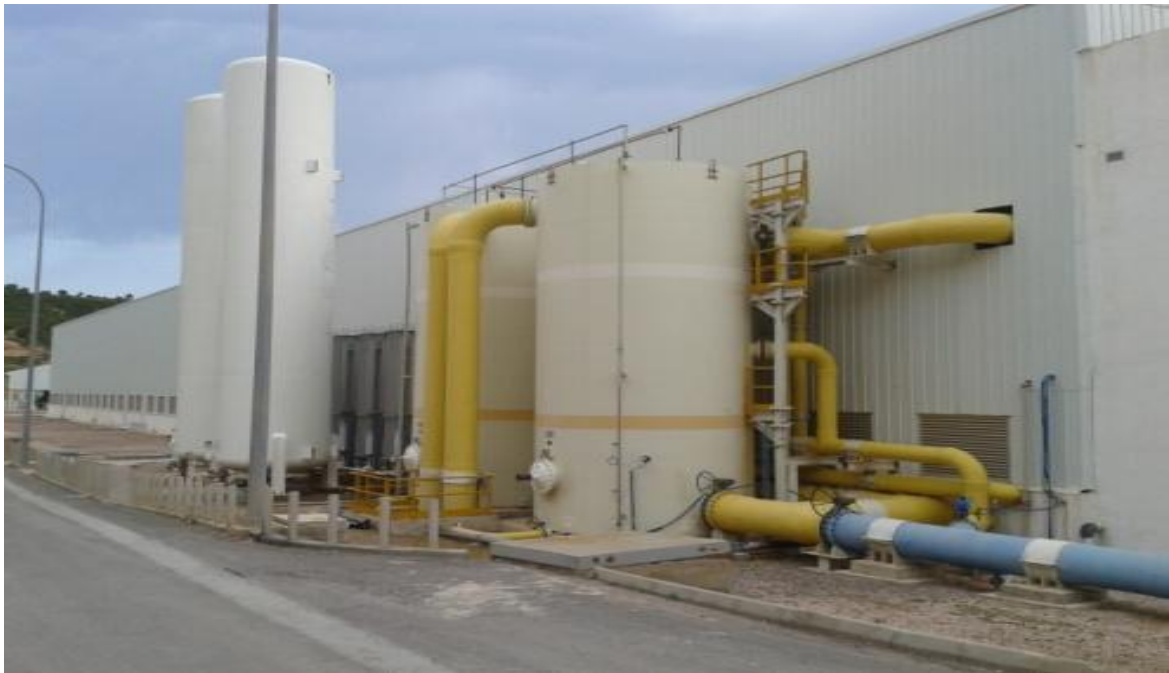
Figure n° (18) : Les réservoirs de CO 2 (Station de Dessalement-Honaine).
