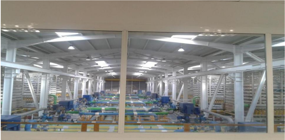
Figure n° (15) : L'étape de l'osmose inverse (Station de Dessalement-Honaine).
