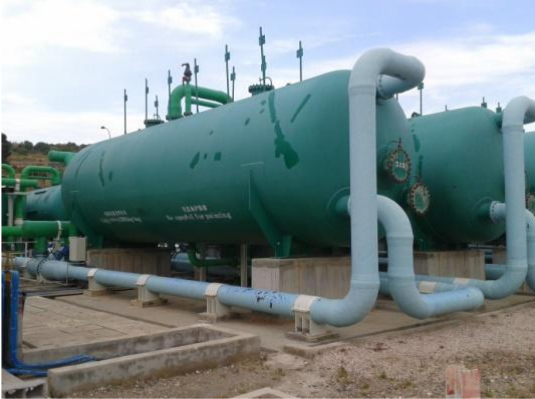
Figure n° (13) : filtres à sables et anthracite (Station de Dessalement-Honaine).
