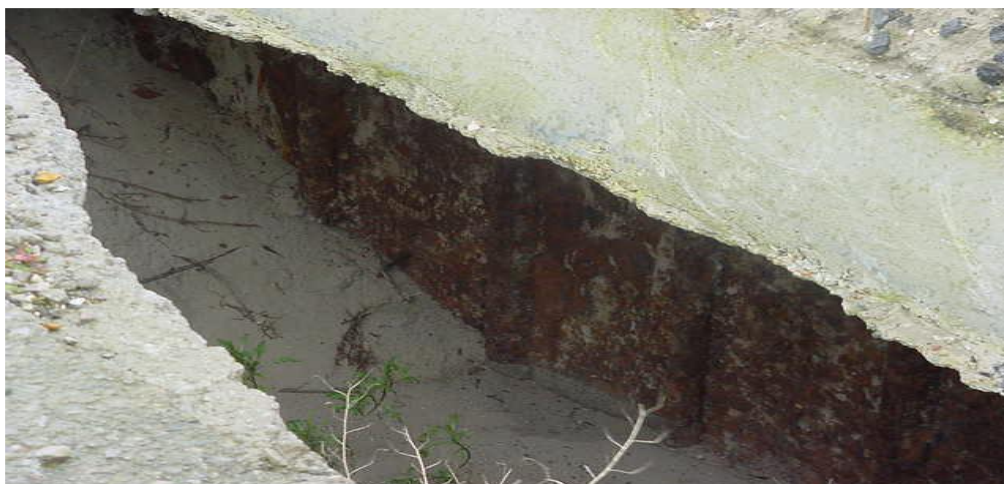
Figure 1.37. Dégradation de rideau de palplanche sous l'effet de corrosion [BRA04]
