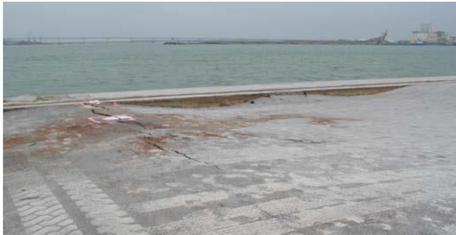
Figure1.36 Dégradation de mur de quai à cause de corrosion de rideau de palplanche[BRA04]
