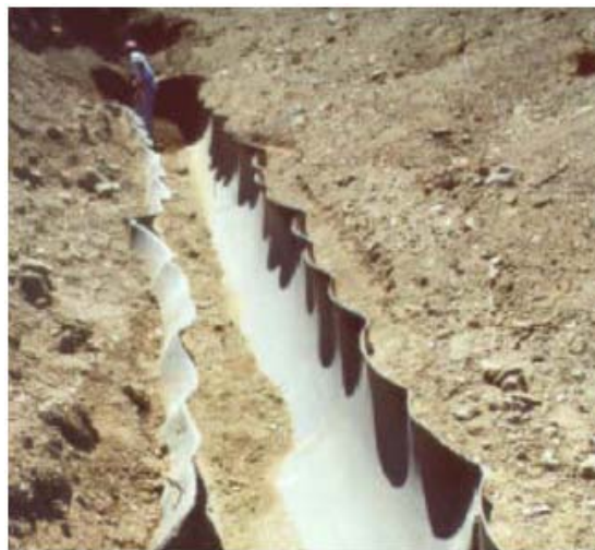
Figure II.8 : Eclatement d'un pipeline [31]
