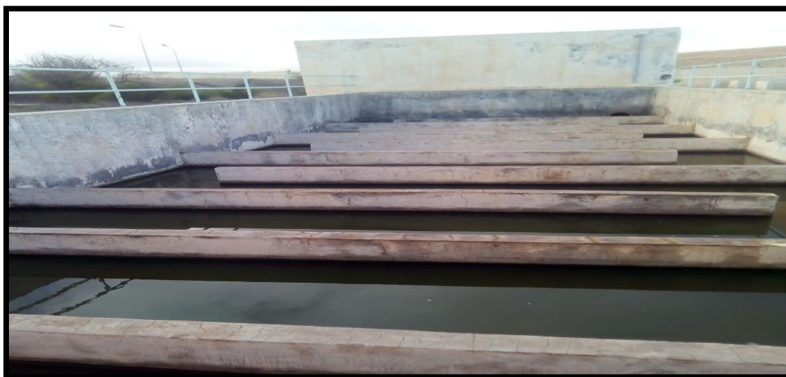
Figure n°55 : station désinfection par chloration (SOUMIA ,2020)
