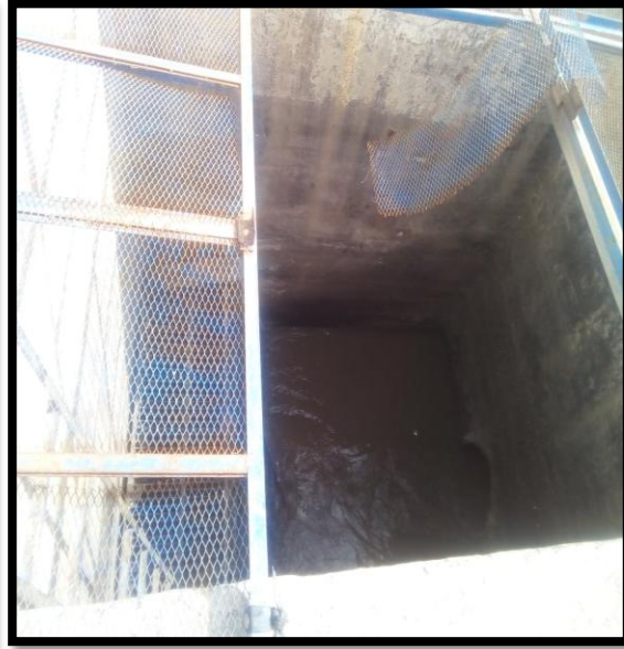
Entrée des eaux usées à la station
