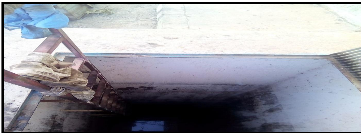
Figure n°45 : Relevage des eaux usées (SOUMIA ,2020)
