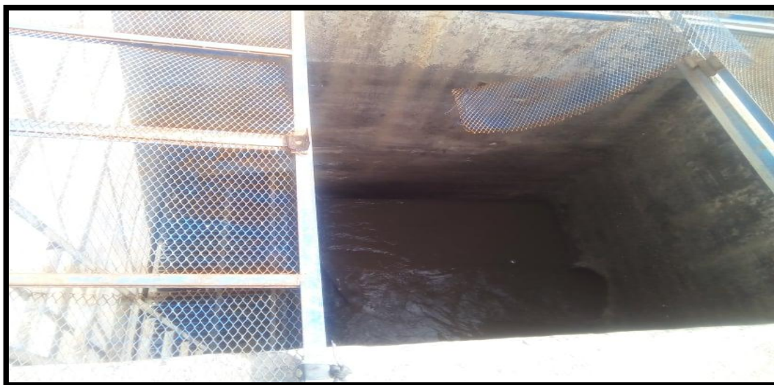
Figure n°44 : Entrée des eaux usées à la station (SOUMIA ,2020)
