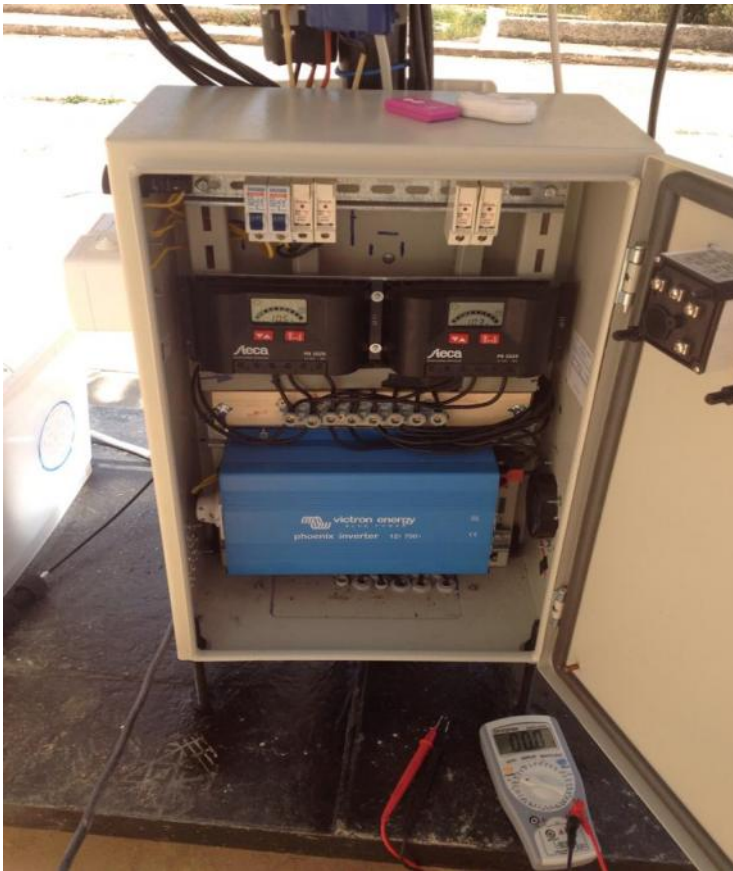
Figure 5.20 : Armoire électrique du générateur PV
