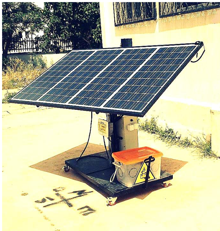
Figure. II. 1 Générateur photovoltaïque de 340 W
