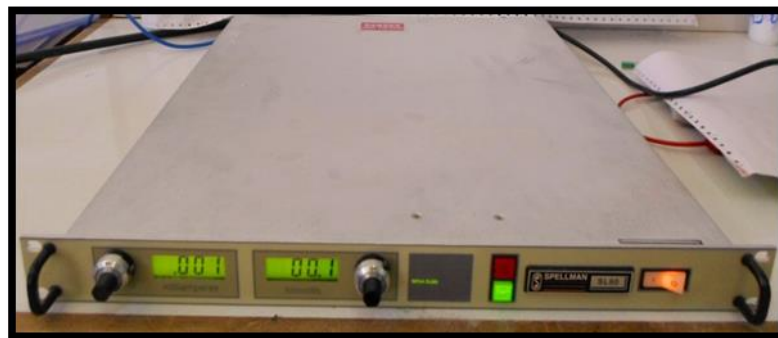
Figure II-7: Sources Haute Tension pour l'alimentation des électrodes du séparateur.
