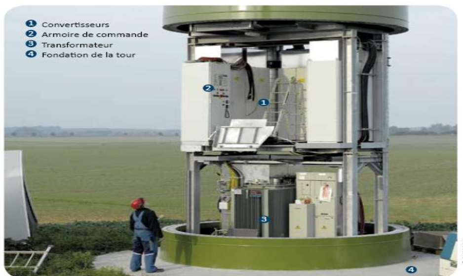
Figure I.22 : Composants électroniques dans le mât d'une éolienne.
