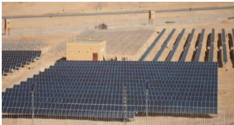
Figure 1.32. Centrale photovoltaïque de Ghardaïa (ME, 2015c).
