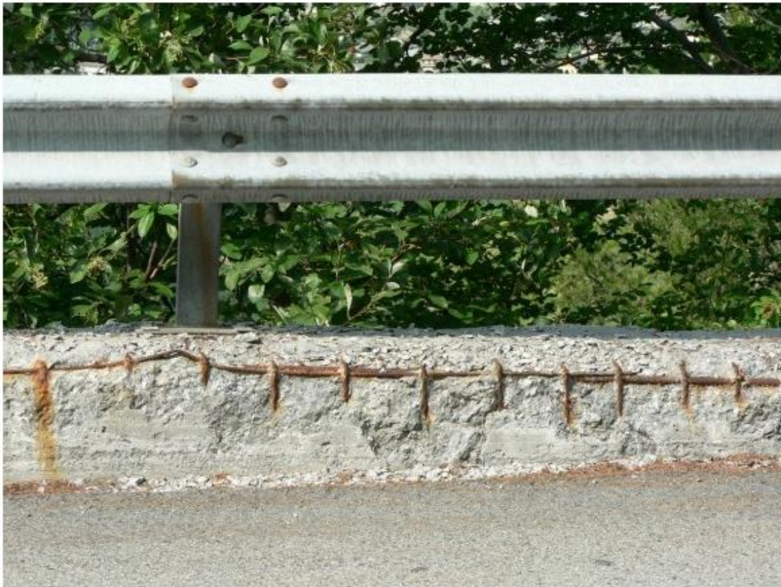
Figure I.6 : Effet du gel-dégel sur le béton : écaillage du béton d'enrobage et corrosion des armatures
