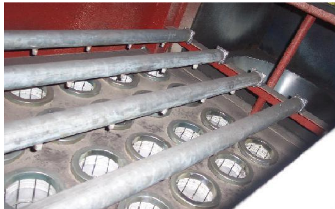
Figure I.12 : Compartiment de circulation d'air filtré
