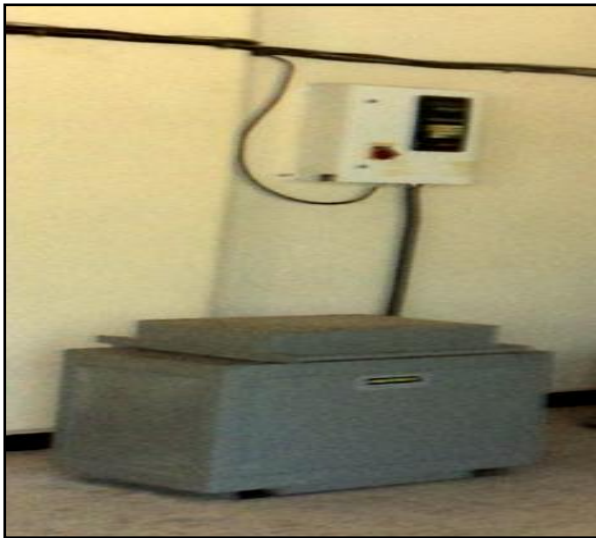
Figure II.16 : Système de chauffe à l'aide d'un four.
