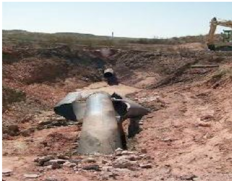
Figure 8 : Explosion d'un pipeline 42'' ( Elgomri –mohamadia)
