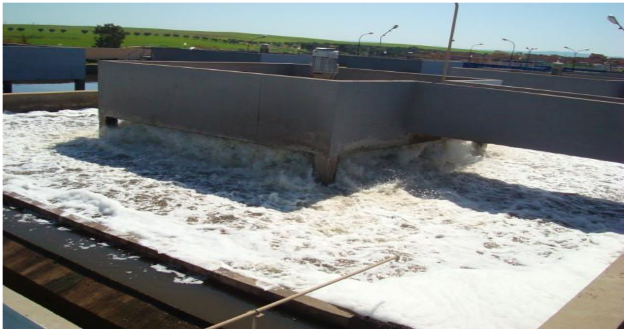
Figure N 15 : Bassin d'aération (ONA, 2021)
