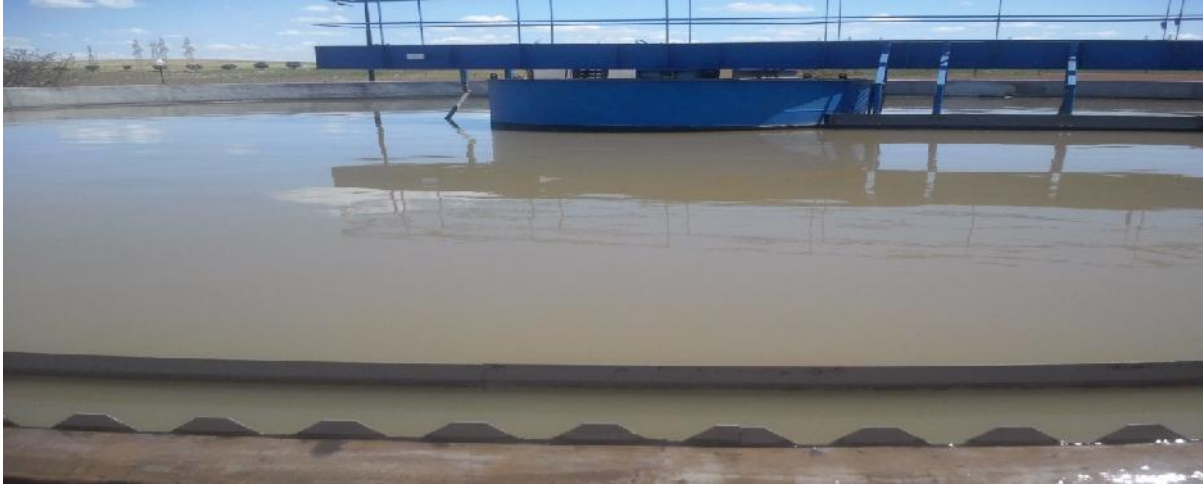
Figure N 14 : Décanteur primaire (ONA de SBA, 2021).
