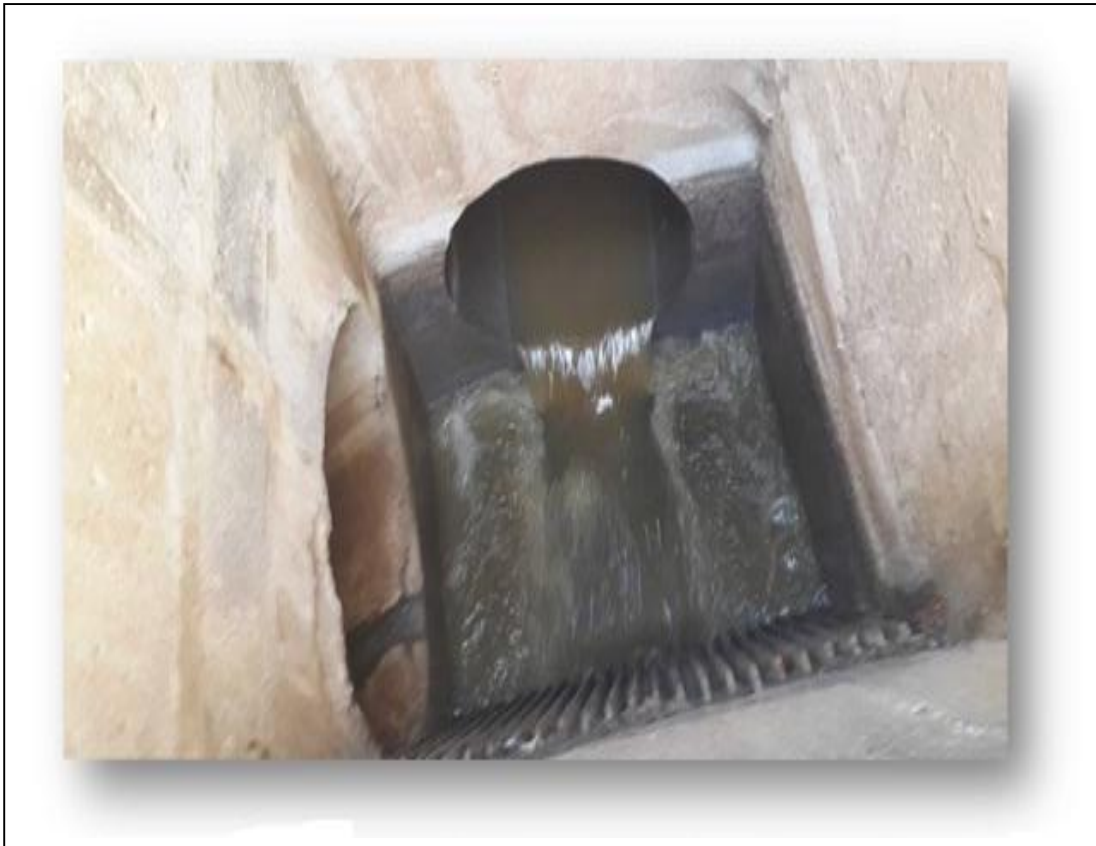
Figure N 11: représente le Déversoir d'orage ( STEP de Sba,2021 )
