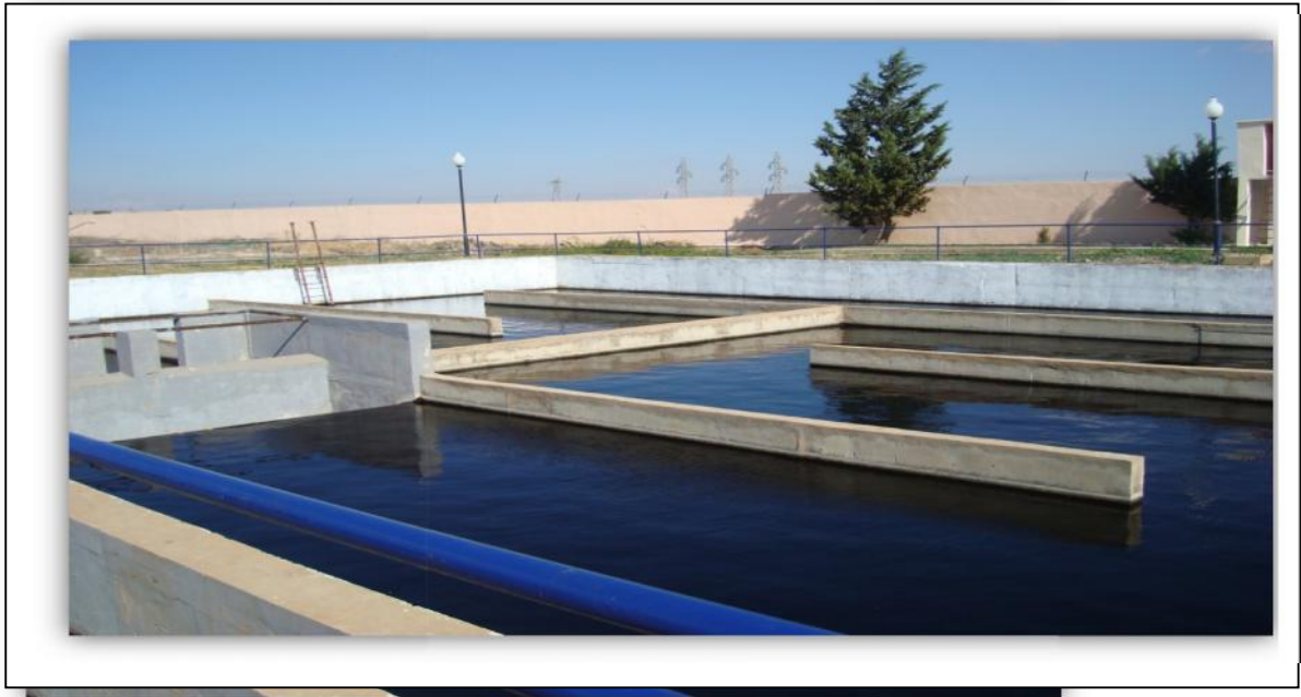
Figure N 21 : Bassin de prises au site (STEP SBA, 2021)
